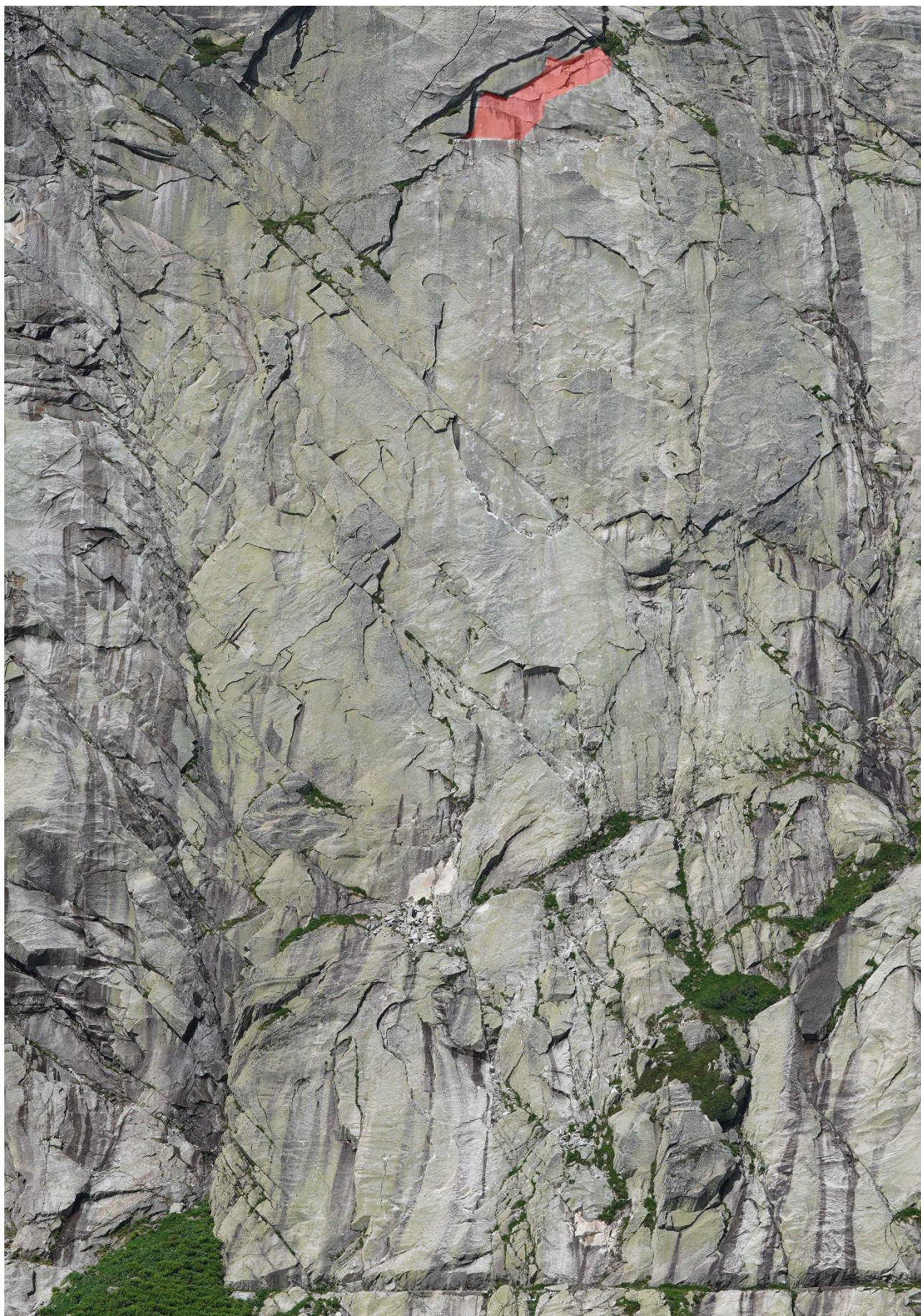
Gesamter Felssturzbereich (im Zentralen Aare-Granit) oberhalb des Wanderweges, Panorama A6601803-5.
